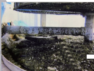
フィルターに混合スケールが 付着している状態
